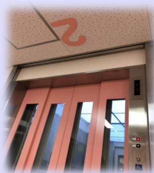
エレベーター
