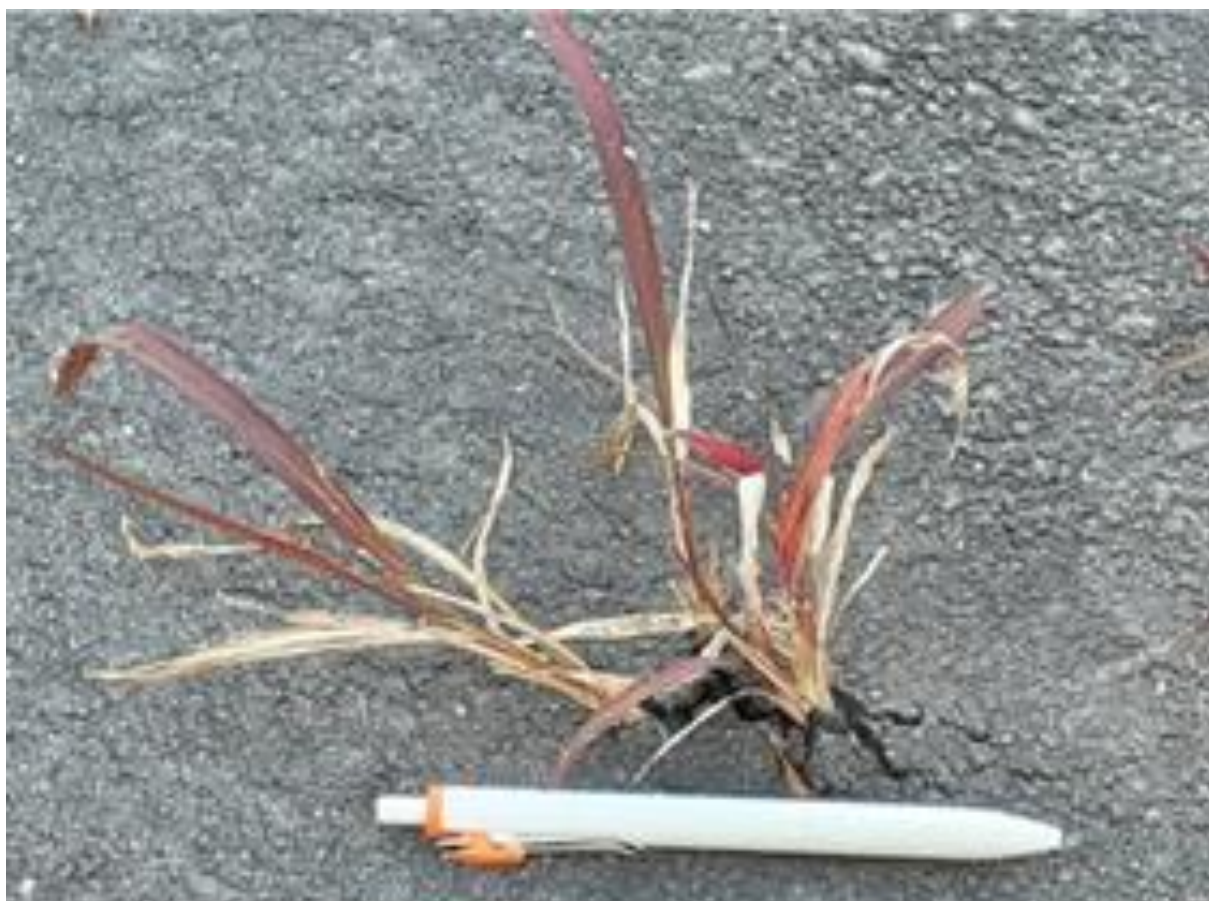
図1:植物がアスファルトを突き破る様子
