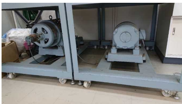
④電動発電機実習装置の設置台下部のモーター1台 発電機1台
