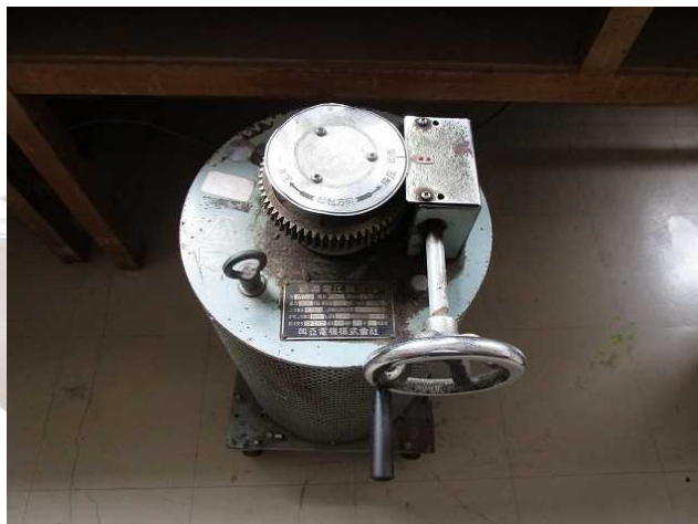
②三相誘導電圧調整器 2 台
