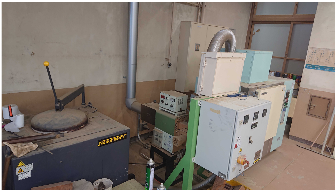
③オープン型電気乾燥炉 1 台、電気炉 1 台、脱臭機 1 台
