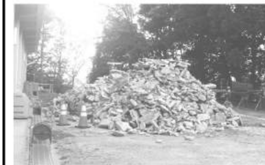
→瓦礫が積みあがっているところ
