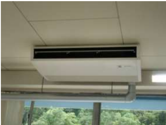
【寄付金で設置した空調機器】
