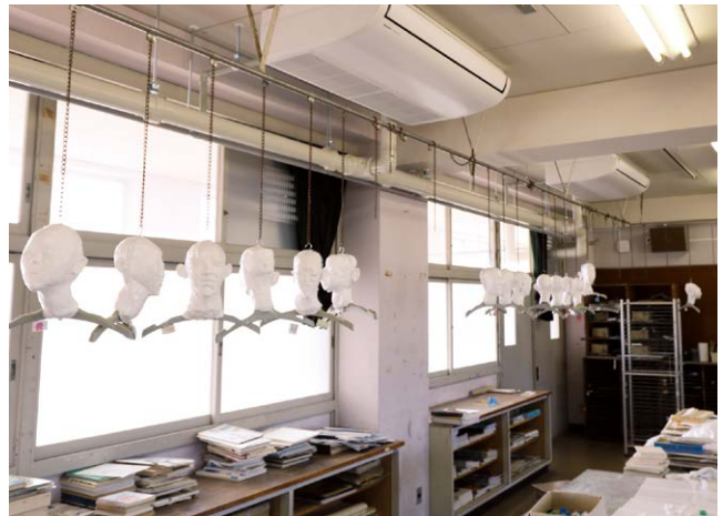
令和7年度（2025）芸術棟の空調設備（美術教室）
