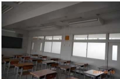
選択科目履修教室空調設備
